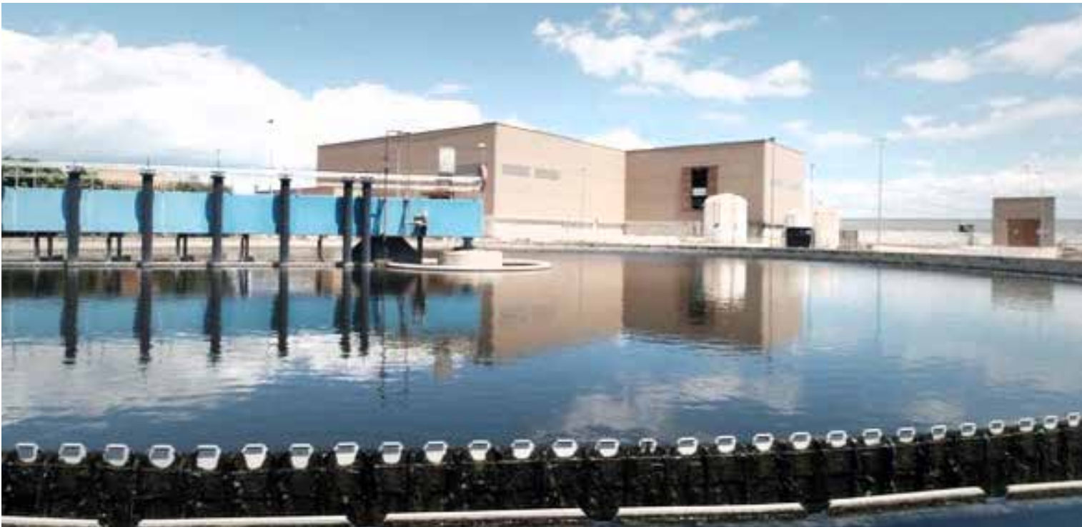
Estación de regeneración de aguas depuradas en el Prat, AM de Barcelona. Fuente: Agencia Catalana del Agua.
